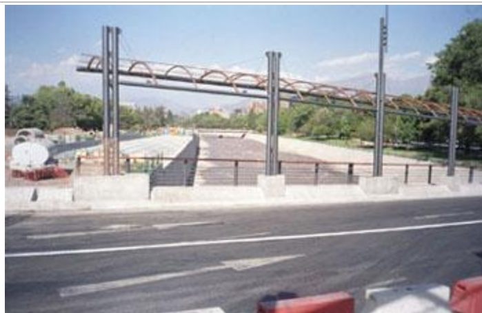
Vista al oriente con el angostamiento del cauce del río Mapocho, producto de las obras de la Costanera Norte en caja a la iz., en construcción.
